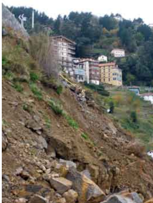
Lur-jausien xehetasunak. Detalle de los desprendimientos.
